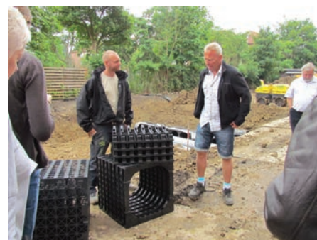
Figur 17: Faskinekassetter ved anlægsarbejde i Valby. Foto Orbicon
