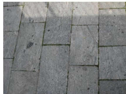
Figur 33: Permeabel flisebelægning i Ørestaden København. Regnvandet kan sive ned gennem belægningens fuger. Foto Orbicon.
